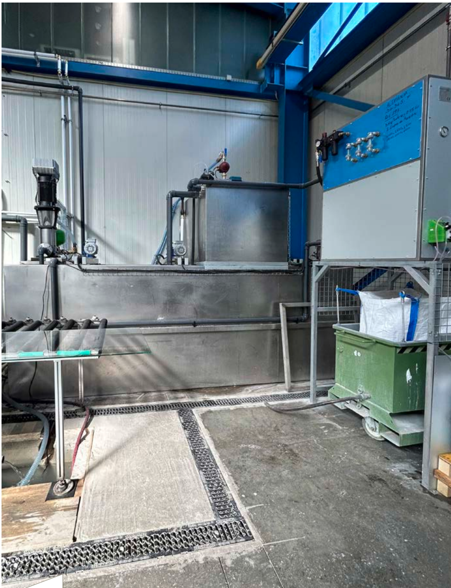
Die Filtraglass Wasseraufbereitungs-Anlage können aufgrund des modularen Aufbaus leicht an Kapazitätserweiterungen des Glasbetriebs angepasst werden. Hier eine Anlage im Werk von Reli Glas in Eppingen.
